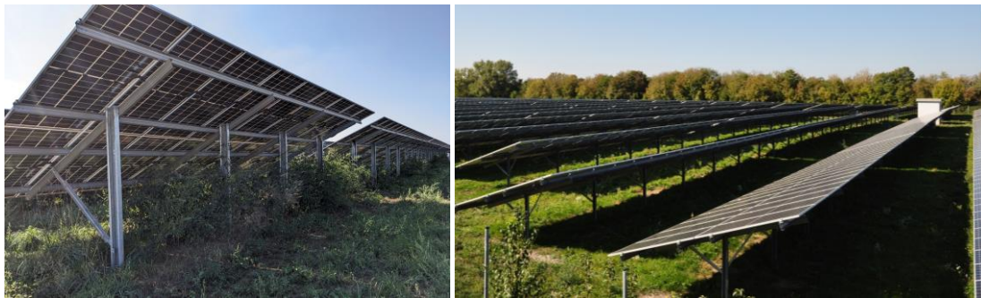
Abbildung 6: Beispiel PV-Freiflächenanlage gemäß EAG Mindeststandards
